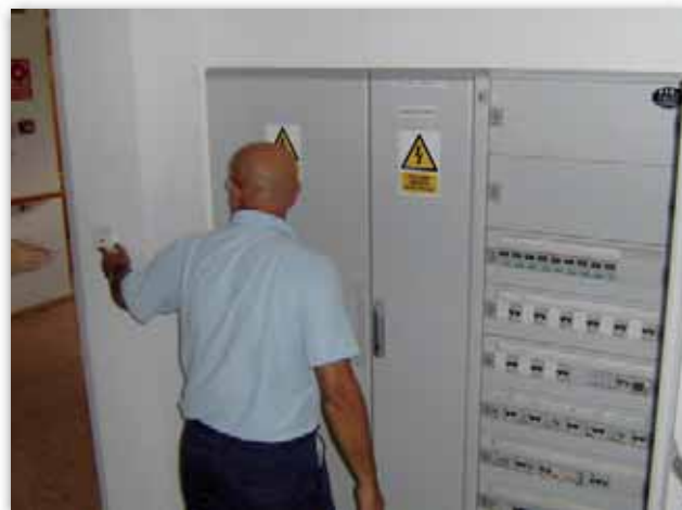
Siempre que surge una avería, una vez superada se comprueba su funcionamiento
