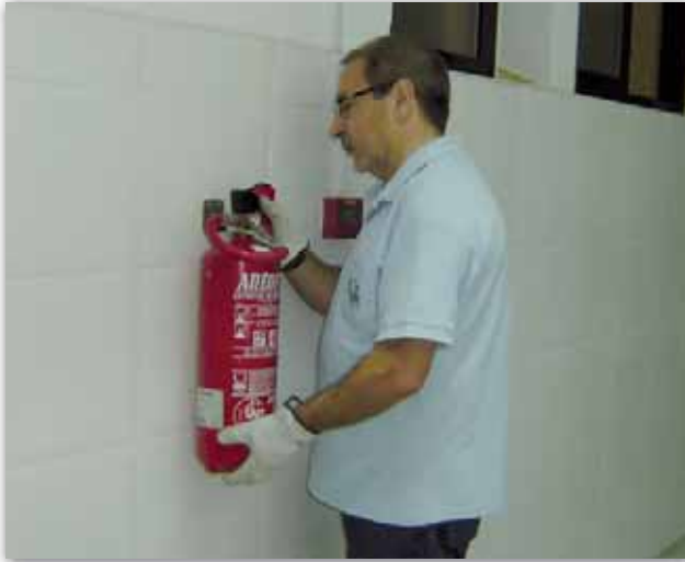
Revisión programada de extintores de incendio
