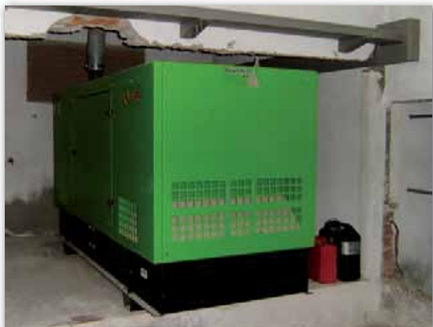
Generador eléctrico de la Residencia
