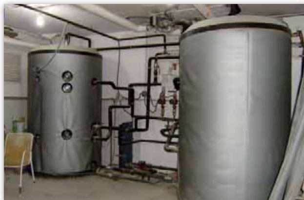
Acumuladores de agua caliente sanitaria
